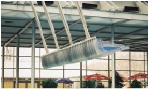
Wasserfall ausgeschaltet und in Betrieb
