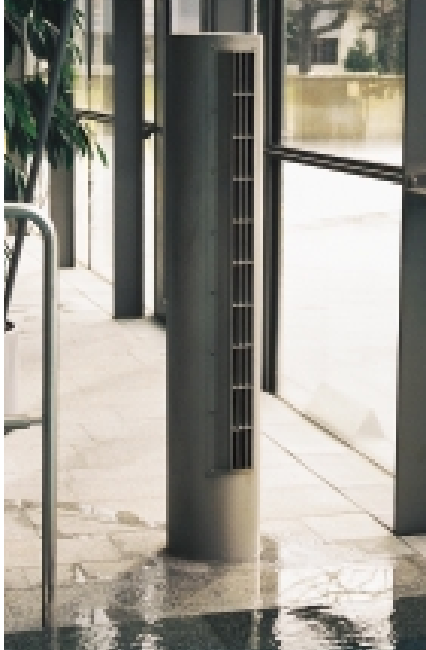
Lüftungselement am Ausschwimmkanal
